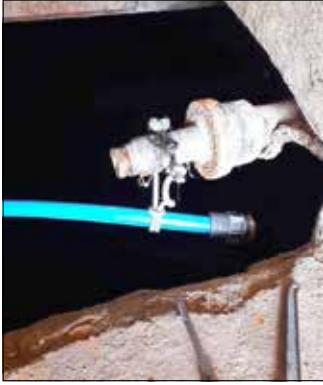
Die alte Gussleitung im Bassin
